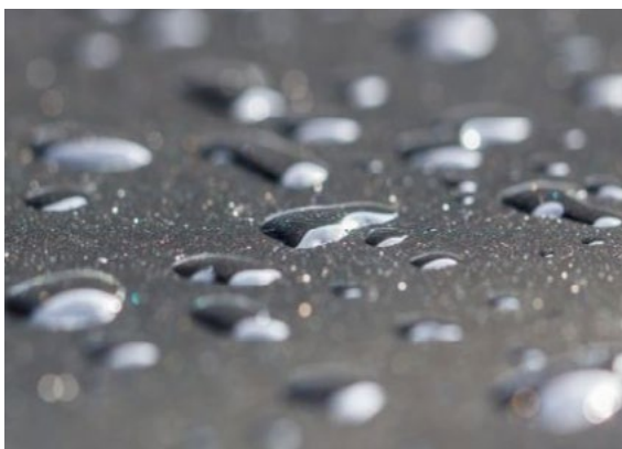
Effet de l'humidité sur du béton traité
